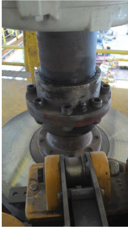
Figura 23 - Acoplamento inspecionado Fonte: Rocha (2014)
