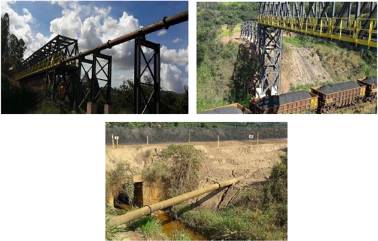
Figura 14: Travessias aéreas de um rejeitoduto. Fonte: Minérios e Minerais (2021).
