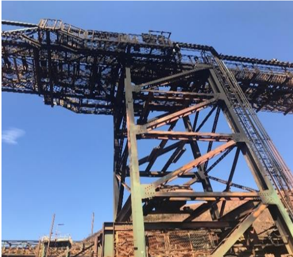
Figura 29 - Estrutura antes da manutenção. Fonte: Pesquisa direta (2022).
