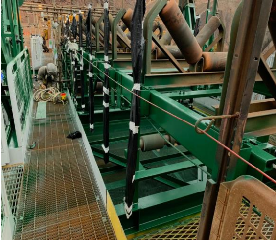
Figura 25 - TAC nas estruturas. Fonte: Pesquisa direta (2022).
