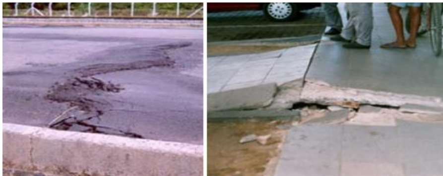
Figura 3.7: Manifestações patológicas decorrentes do uso de escórias de aciaria como material de adição na construção civil (MASUERO; VILELA; DAL MOLIN, 2004).
