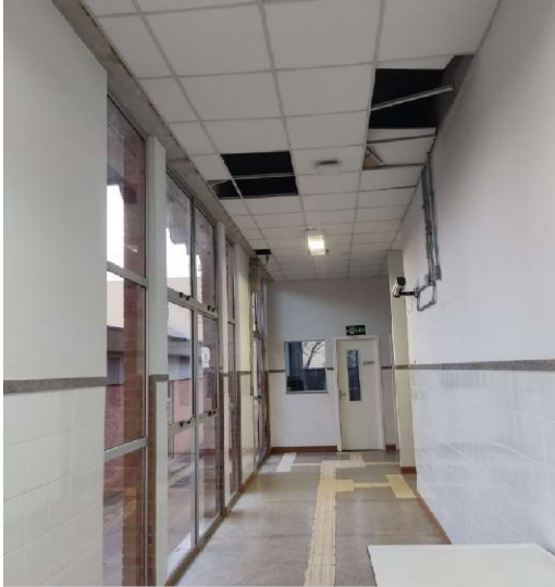
Figura 28 – Forro precisando de manutenção na via de acesso as Plantas Piloto
