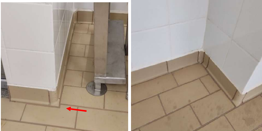
Figura 38 – existência de ângulos abaulados entre as paredes e o piso.
