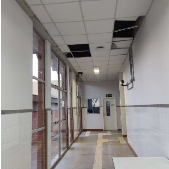
Figura 7 – Forro precisando de manutenção na via de acesso as plantas piloto.
