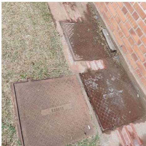
Figura 20 – Rede de esgoto das plantas piloto da Escola de Nutrição.
