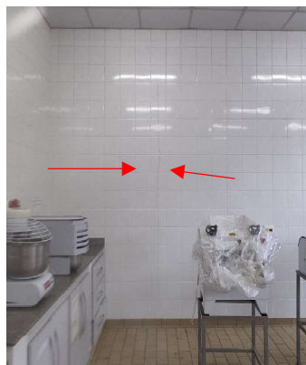
Figura 35 - Parede da Planta Piloto de Produtos Amiláceos com uma rachadura
