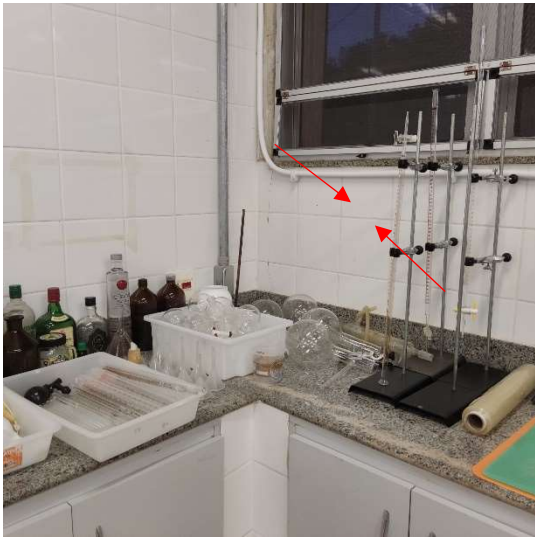
Figura 37 - Parede com rachadura na Planta
