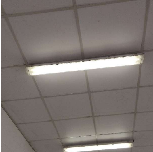
Figura 18 – Luminárias com presença de proteção contra quebras utilizadas em todas as plantas piloto da escola de nutrição
