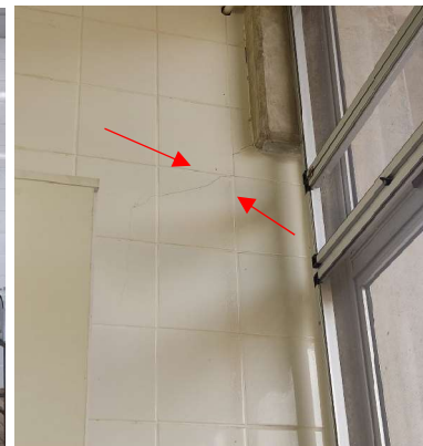
Figura 36 - Parede da Planta Piloto de Produtos Vegetais e Bebidas
