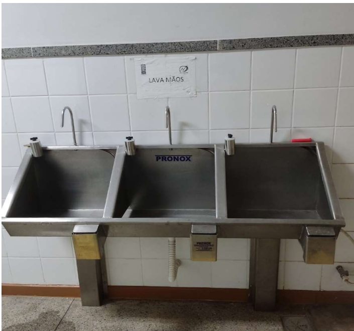
Figura 9 – Pia para lavagem das mãos localizada na entrada da via de acesso as plantas piloto
