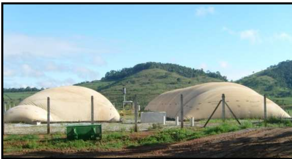
Figura 7: Biodigestores tubulares da granja São Francisco – Ponte Nova MG
