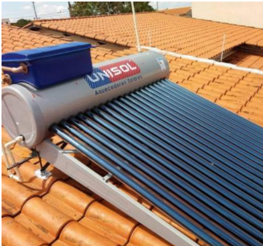
Figura 12 – Coletor solar de tubos a vácuo instalado Fonte: PatroSol
