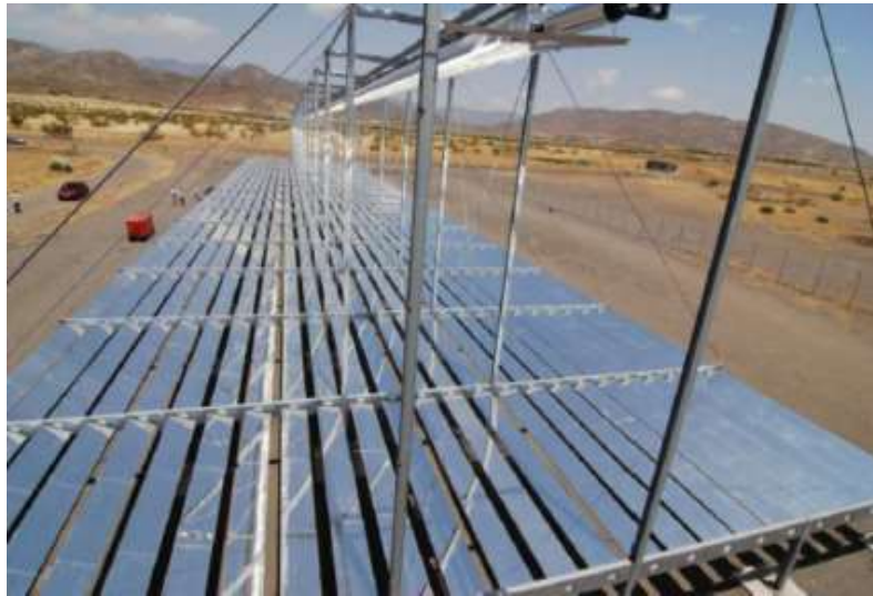
Figura 7: concentrador solar Fresnel. Fonte: UNISINOS (2017)
