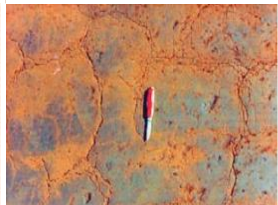
(d) Solo arenoso fino laterítico LA': trincas devido à perda de umidade da camada compactada
