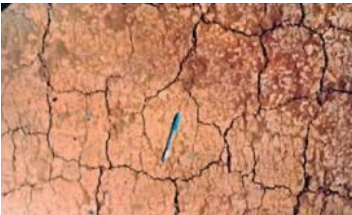
(e) Argila arenosa laterítica LG': trincas devido à perda de umidade da camada compactada
