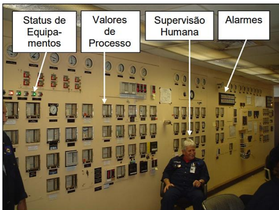
Figura 4 - Antigos painéis de controle Fonte: The High-Performance HMI Handbook (2008)
