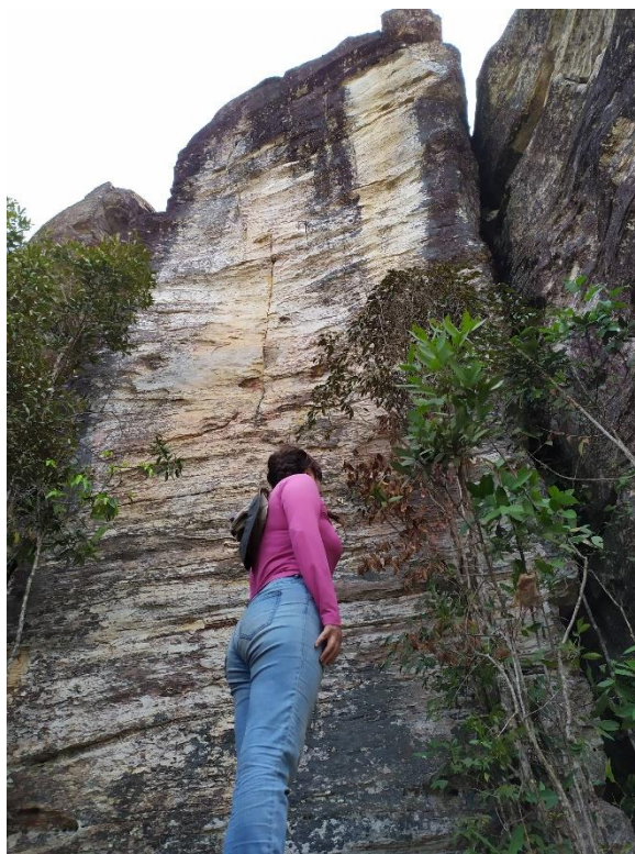
Figura 4.10 - Via do meio: evidência de fraturas lisas não preenchidas com espaçamento médio de 2 metros e trincas com menor persistência de menor espaçamento. Fonte: acervo pessoal.
