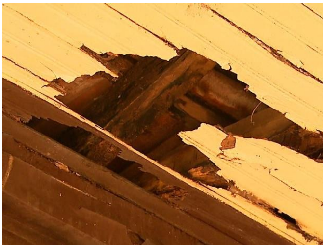
Figura 3 – Forro danificado por cupins (Museu do Café, Ribeirão Preto – Foto: Maurício Glauco12).
