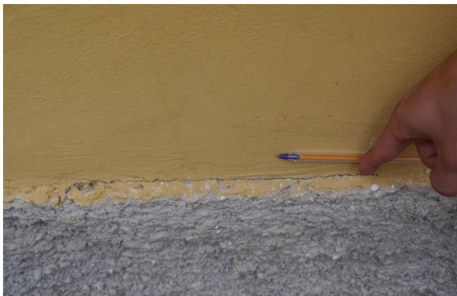
Figura 38: Fissura geométrica horizontal na base da alvenaria na fachada frontal provavelmente originada pela movimentação diferencial entre alvenaria e alicerce estrutural. Fonte: autor.
