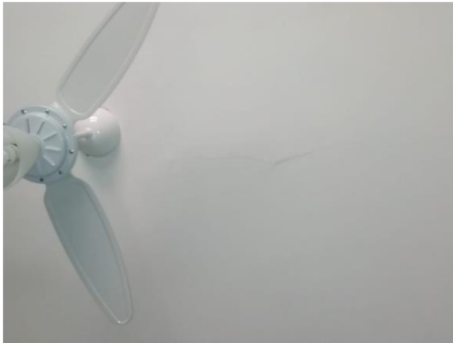
Figura 45: Fissura provavelmente causada pelo embutimento de tubulação elétrica no teto. Fonte: autor.
