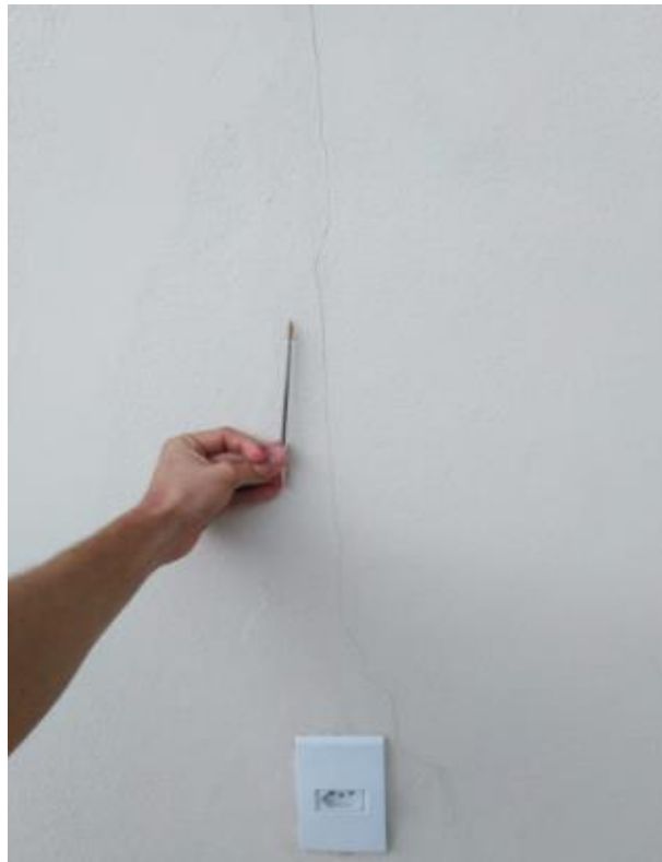
Figura 44: Fissura possivelmente causada pelo embutimento de tubulação elétrica na alvenaria. Fonte: autor.
