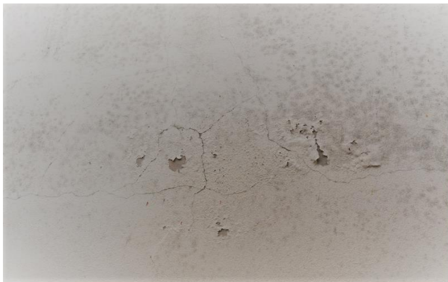
Figura 40: Fissura mapeada em argamassa de revestimento na fachada lateral direita do imóvel formada pela restrição à movimentação dos elementos. Fonte: autor.
