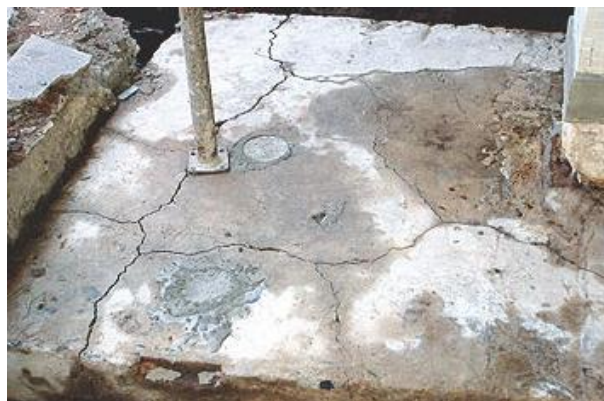
Figura 23: Bloco de fundação fissurado por consequência da RAA (CICHINELLI, 2007).
