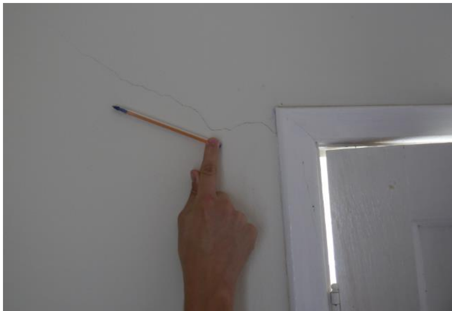
Figura 43: Fissura na parte superior do vão de porta sem verga com inclinação próxima de 45°. Fonte: autor.
