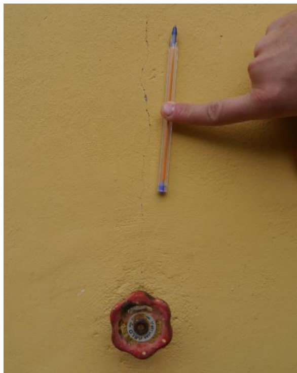
Figura 46: Fissura provavelmente causada pelo embutimento de tubulação hidráulica na alvenaria. Fonte: autor.
