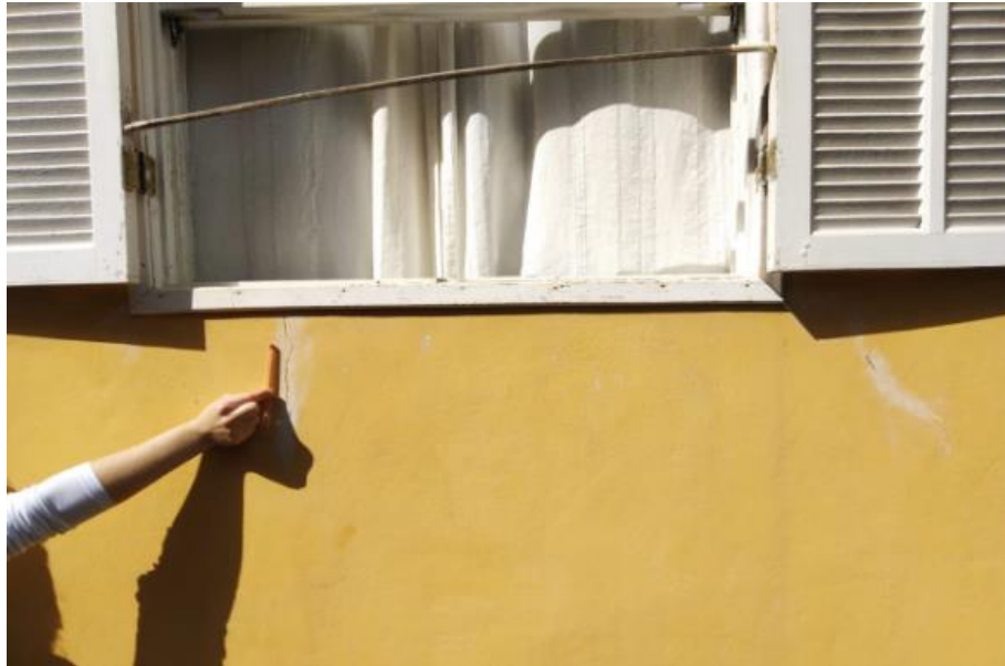
Figura 42: Fissura inclinada no canto inferior e com direção vertical no centro do vão de janela sem verga e contraverga. Fonte: autor.
