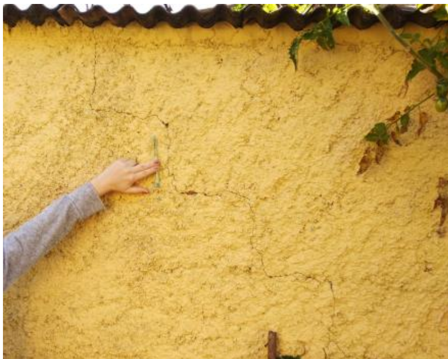
Figura 37: Trinca em muro de bloco de concreto acompanhando a argamassa de assentamento dos blocos causada por variação térmica da estrutura. Fonte: autor.
