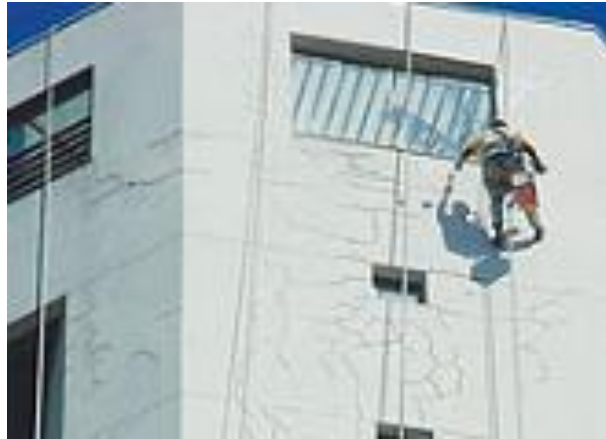
Figura 15: Configuração típica de fissura mapeada em fachada de prédio formada pela restrição à movimentação do reboco (SAHADE, 2005).
