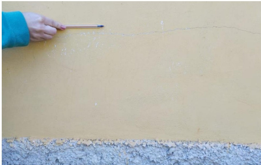
Figura 39: Fissura geométrica horizontal em camada inferior da alvenaria na fachada posterior possivelmente devido à movimentação diferencial das primeiras camadas da alvenaria. Fonte: autor.
