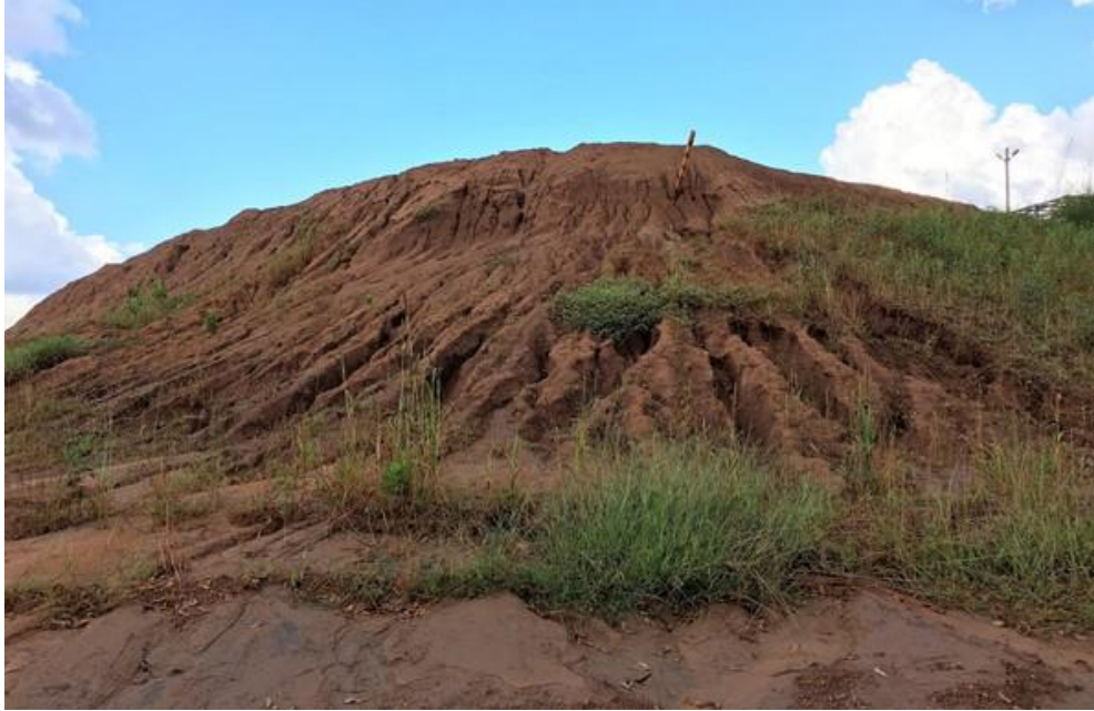
Figura 5.4. Processo erosivo avançado.
