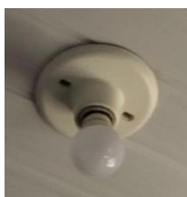
Figura 26: Tipo de luminária das edificações
