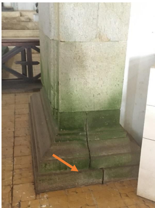
Figura 35 – Trinca interna. Fonte: Autora.
