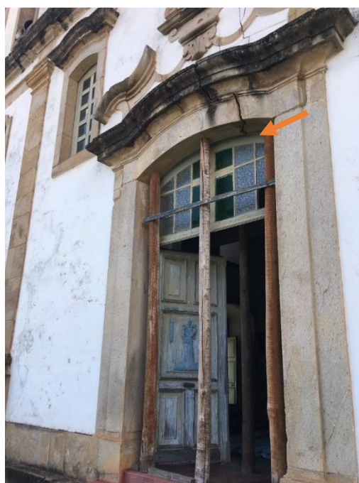
Figura 38 – Trinca na fachada e escoramento feito pelos moradores. Fonte: Autora.
