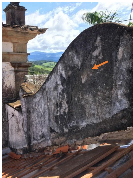
Figura 39 – Trinca parte interna da fachada principal. Fonte: Autora.
