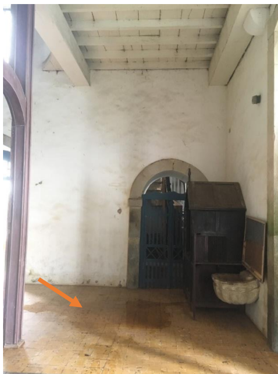
Figura 36 – Falha na cobertura causando acúmulo de água das chuvas. Fonte: Autora.
