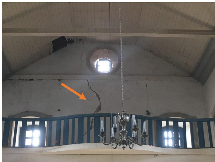
Figura 34 – Trinca interna. Fonte: Autora.
