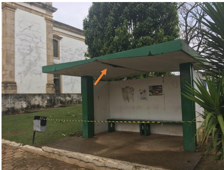
Figura 37 – Ponto de ônibus ao lado da igreja com presença de trincas. Fonte: Autora.
