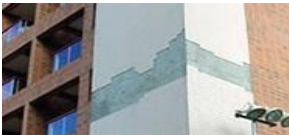
Figura 2.4: descolamento de peças cerâmicas. Fonte: http://www.aecweb.com.br .
