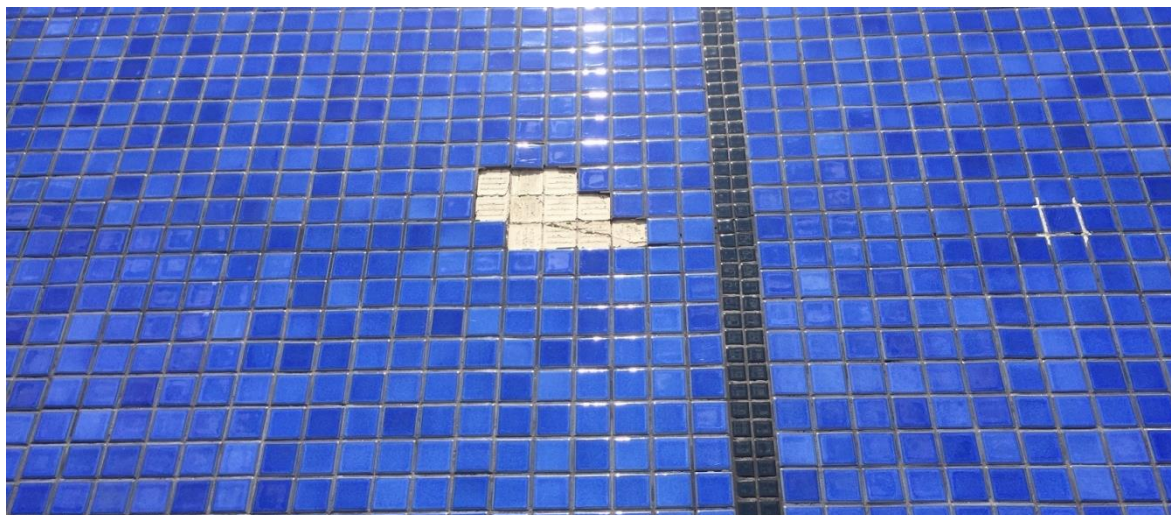
Figura 7.17: destacamento de peças cerâmicas.
