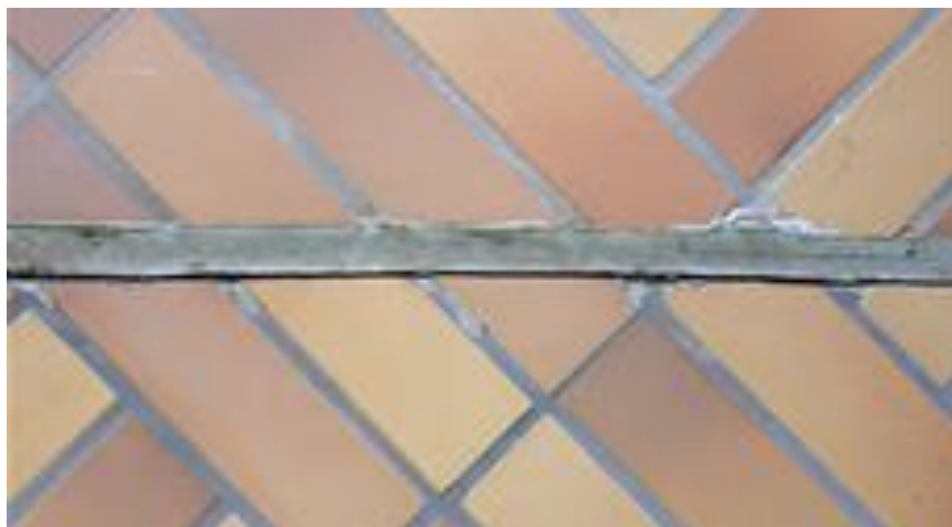
Figura 2.9: deterioração das juntas. Fonte: Revista Técnica. São Paulo: PINI, ed.116, nov. 2006.
