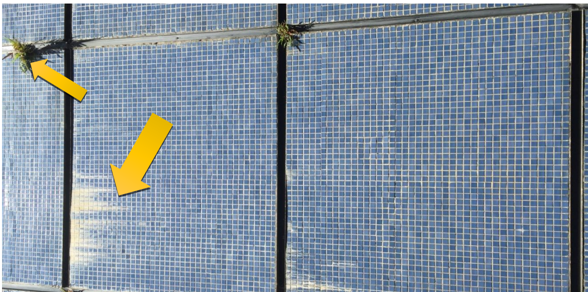
Figura 7.12: Aparecimento de plantas e manchas de cor esbranquiçada.
