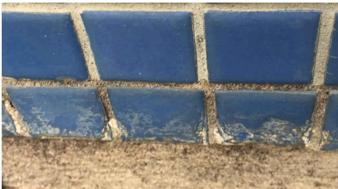
Figura 7.8: apresentação de manchas esbranquiçadas.
