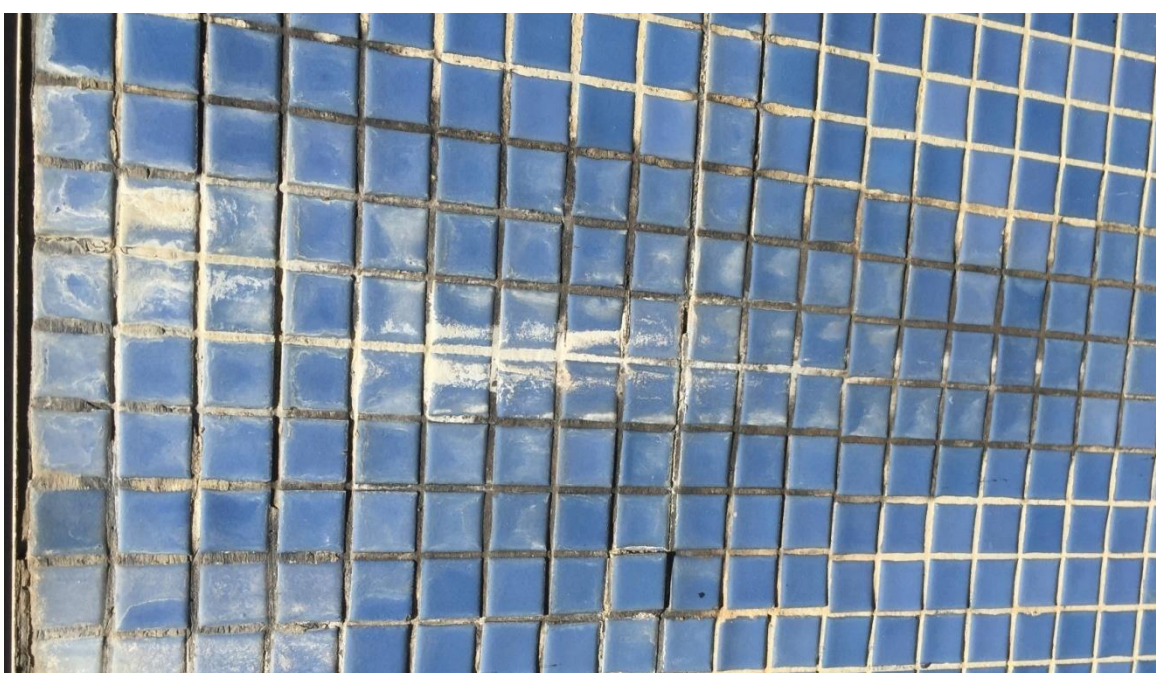
Figura 7.13: manchas de cor clara (esbranquiçada), presentes na estrutura.
