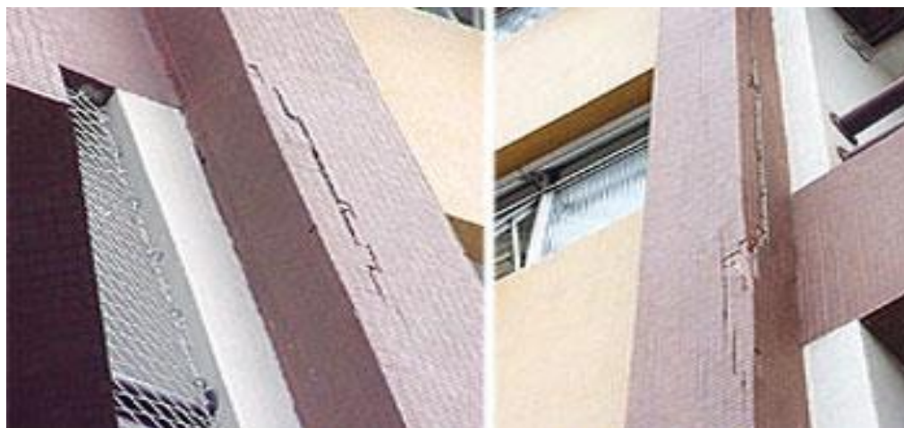
Figura 2.8: revestimento de fachada com trincas (fissuras). Fonte: http://piniweb.pini.com.br/ .
