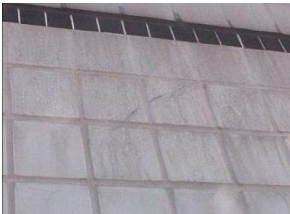
Figura 2.6: Manchamento de revestimento. Fonte: Ribeiro (2006).
