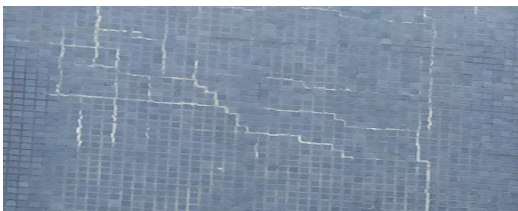
Figura 7.2: ocorrência de manchas esbranquiçadas na fachada.
