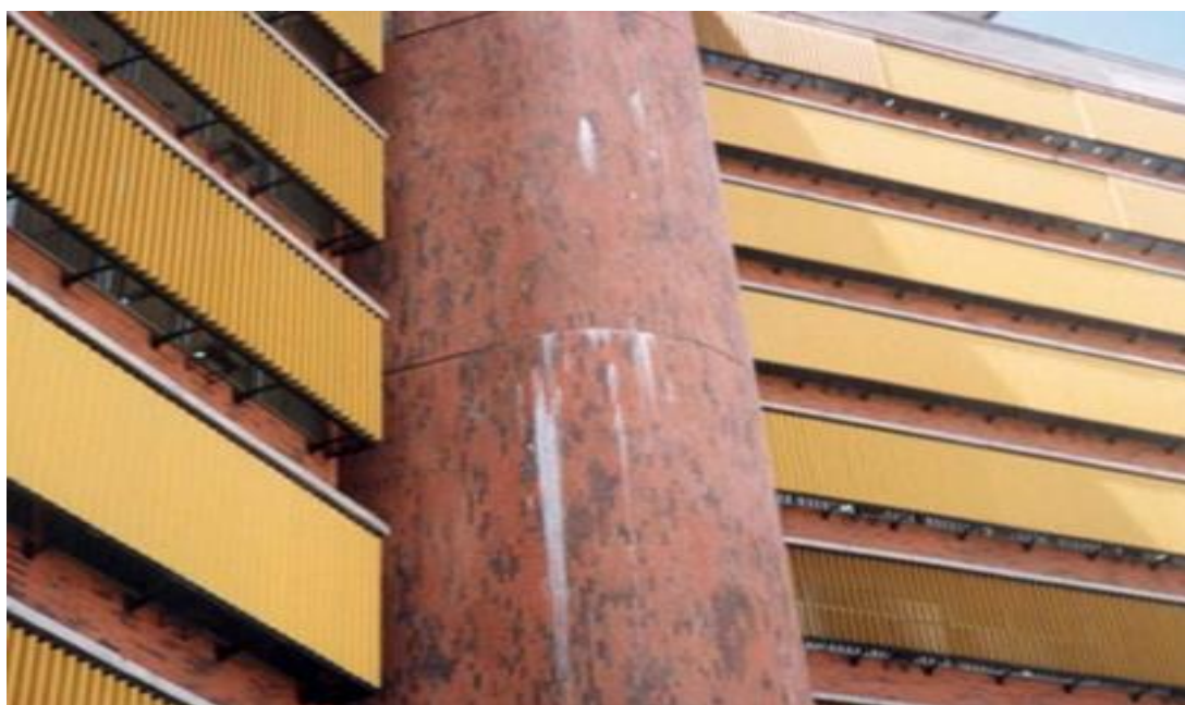
Figura 2.11: eflorescência presente no revestimento de fachada cerâmico. Fonte: http://oazulejista.blogspot.com.br/ .
