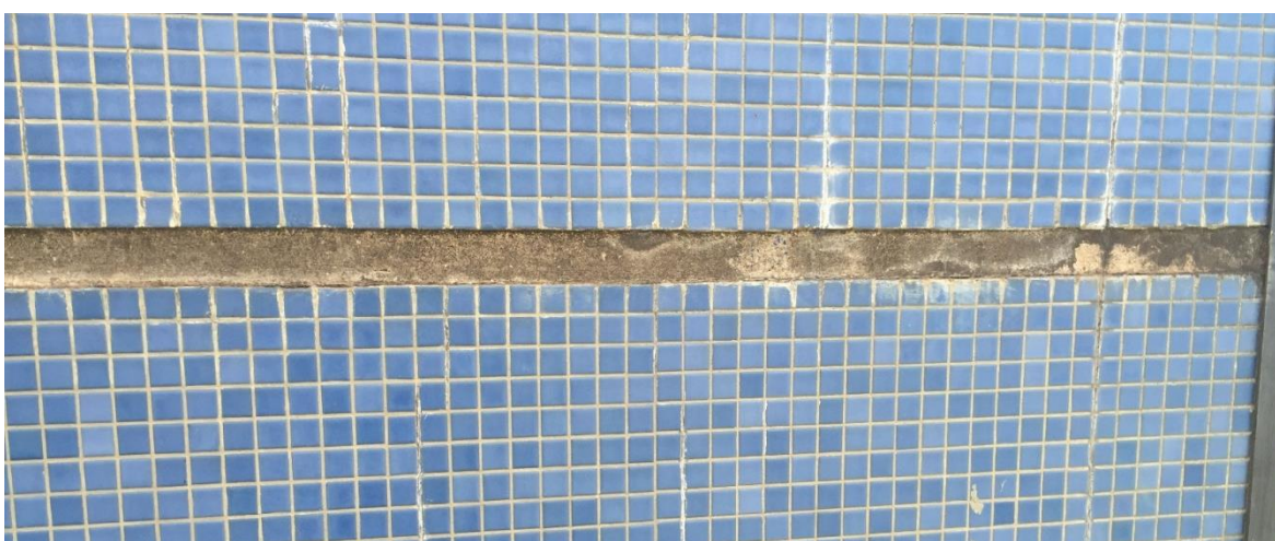
Figura 7.6: aparecimento de manchas e divisória em concreto aparente.
