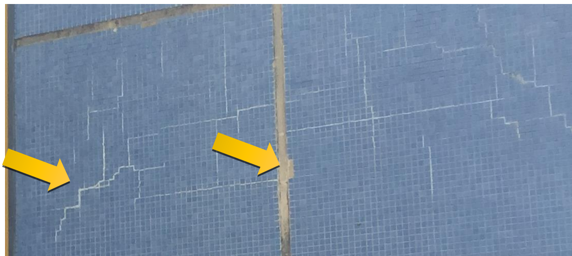
Figura 7.7: presença de manchas e ocorrência de destacamento de pastilhas.
