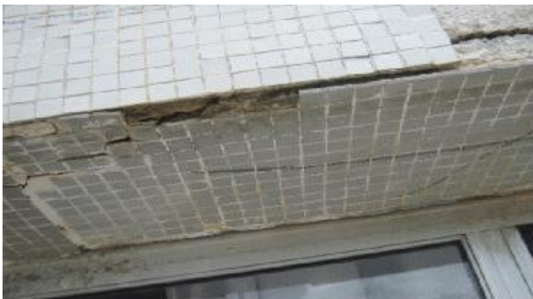
Figura 2.2: trincas e fissuras em fachadas. Fonte: http://www.balbueno.com.br/ .
