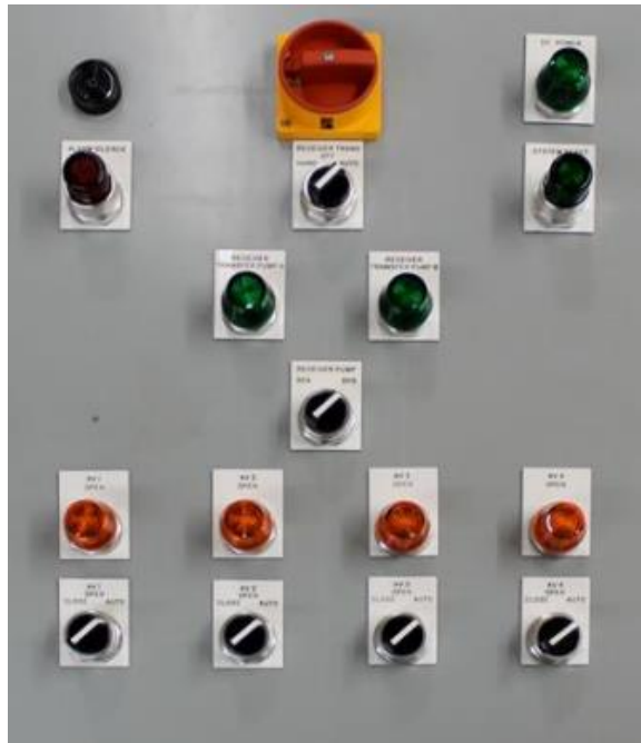
Figura 2: Painel de controle com botoeiras e switches equipados com indicadores luminosos Fonte: Hollifield, 2012
