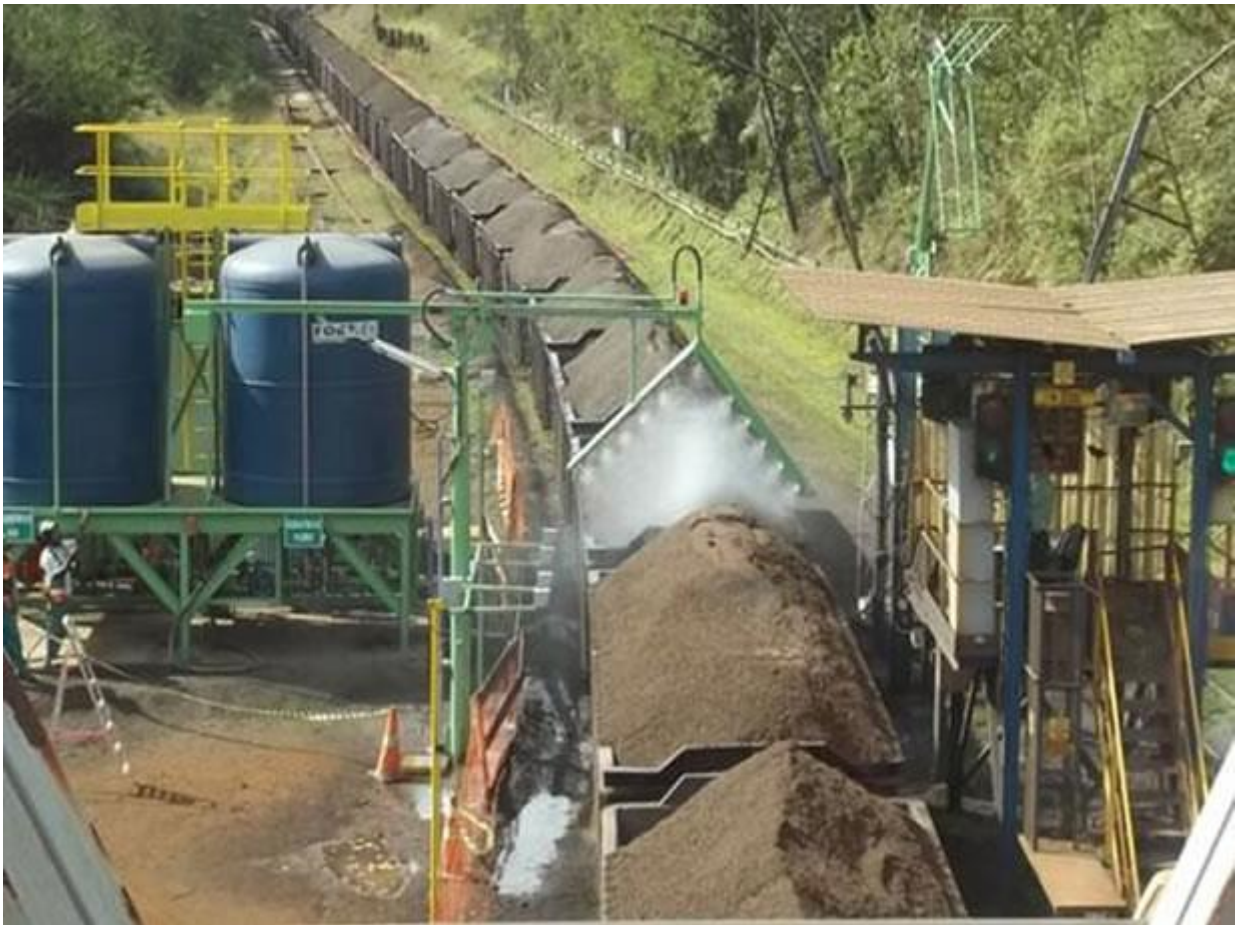
Figura 14: Sistema automático de aspersão em vagões carregados de minério Fonte: http://controlarsistemas.com/aspersao-em-vagoes-de-minerio
