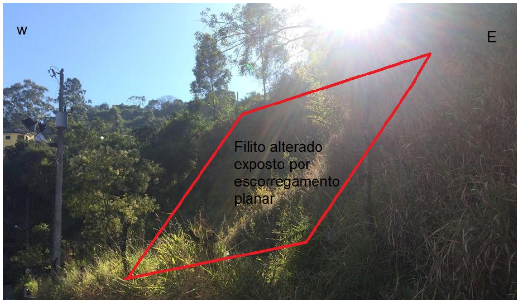
Figura 9.13 - Filito alterado exposto por escorregamento planar de itabirito e material alterado no bairro Piedade. Há evidências pouco sólidas sobre o movimento combinado de escorregamento rotacional. ( Observação em P10 no mapa de pontos – Fig 7.1)
