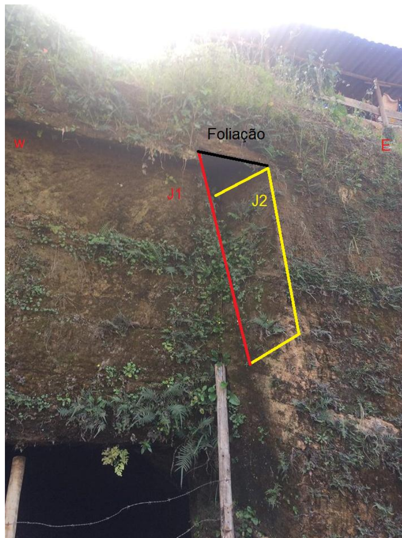
Figura 9.1 - Feições de deslizamento em cunha em itabirito. Os planos de fratura das famílias J1 e J2 em conjunto com a foliação principal favorecem este tipo de movimento de massa. (Observação em P1 no mapa de pontos – Fig 7.1)
