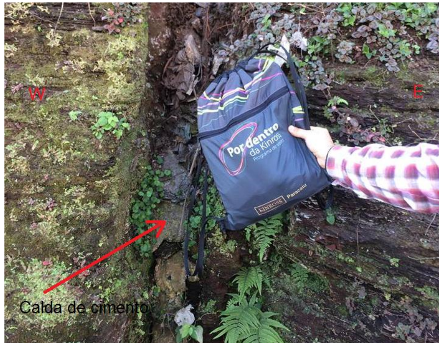
Figura 9.15 - Evidências de ação antrópica. Injeção de caldas de cimento indevidamente em juntas para estabilização parcial de maciço em local onde é observada residência assentada sobre as estruturas no bairro Morro Santana. (Observação em P11 no mapa de pontos – Fig 7.1)
