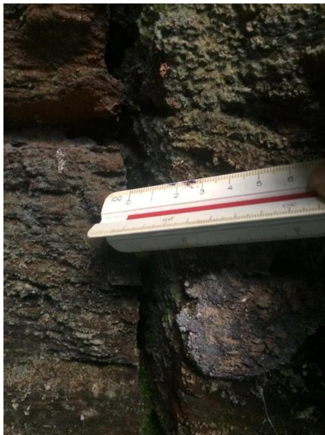
Figura 9.4 - Ocorrência pontual de espaçamento entre descontinuidades maior que 5mm em afloramento de itabirito. (Observação em P1 no mapa de pontos – Fig 7.1)
