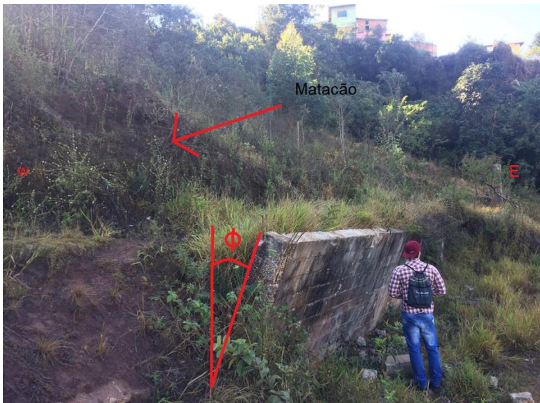
Figura 9.12 - Depósito de Talus. É evidente a inclinação \phi gerada no muro de arrimo devido ao movimento dos matações e material de alteração de itabirito e filito. (Observação em P9 no mapa de pontos – Fig 7.1)
