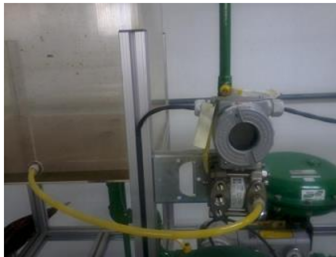
Figura 2.12: LIT-01 Transmissor de Nível.
