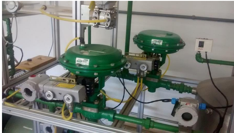
Figura 2.14: Válvulas de Controle e os Posicionadores das Válvulas.
