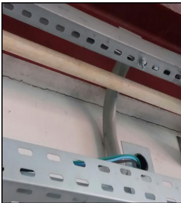
Figura 3:Trinca horizontal: parede/estrutura
