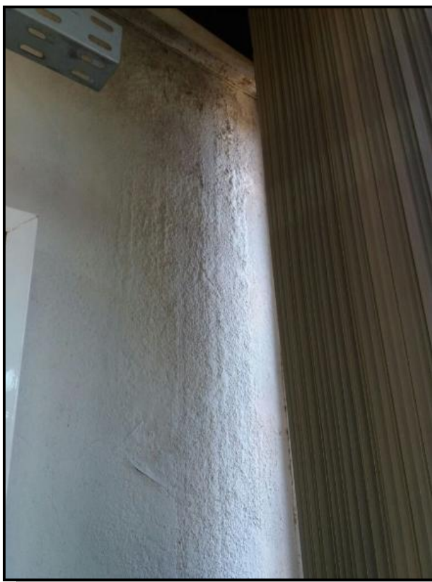
Figura 12: Danos na pintura do laboratório
