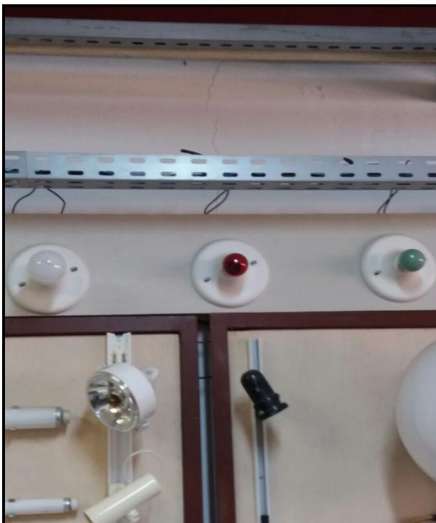
Figura 6: Fissura vertical em parede
