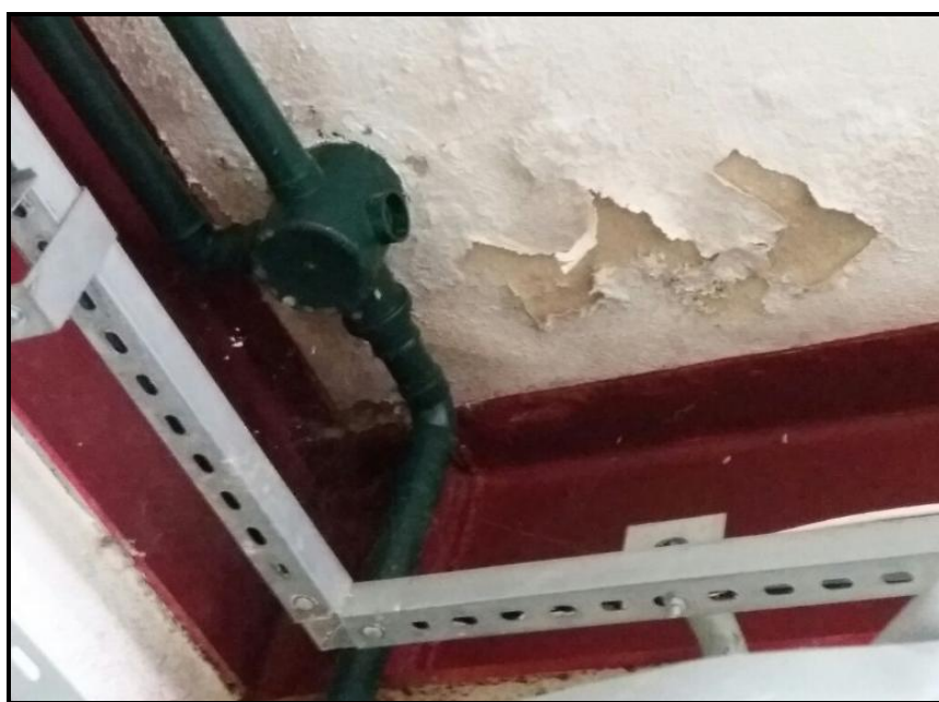
Figura 13: Desprendimento da pintura
