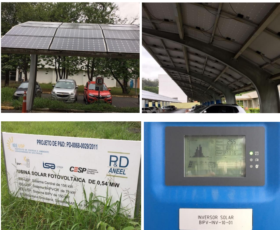
Figura 17: Sistema fotovoltaico do estacionamento da USP (Cidade Universitária, SP).
