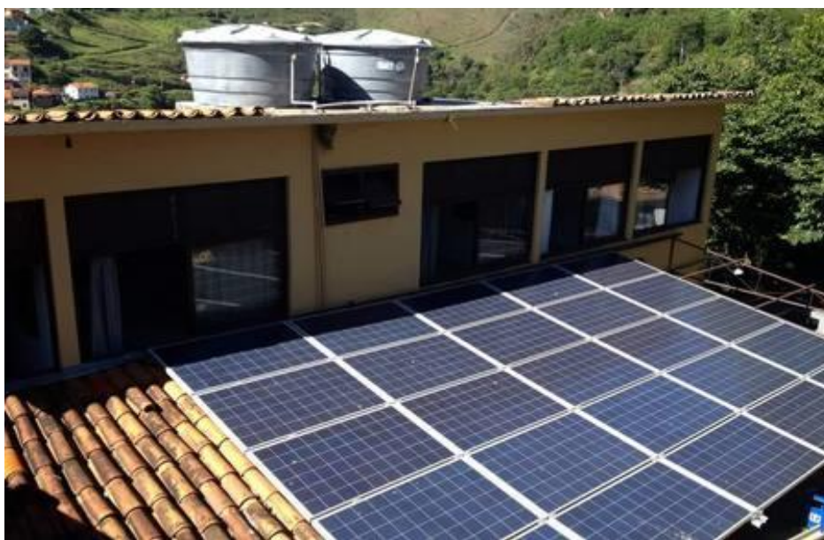
Figura 18: Sistema de aquecimento solar por placas fotovoltaicas da república Reino de Baco.
