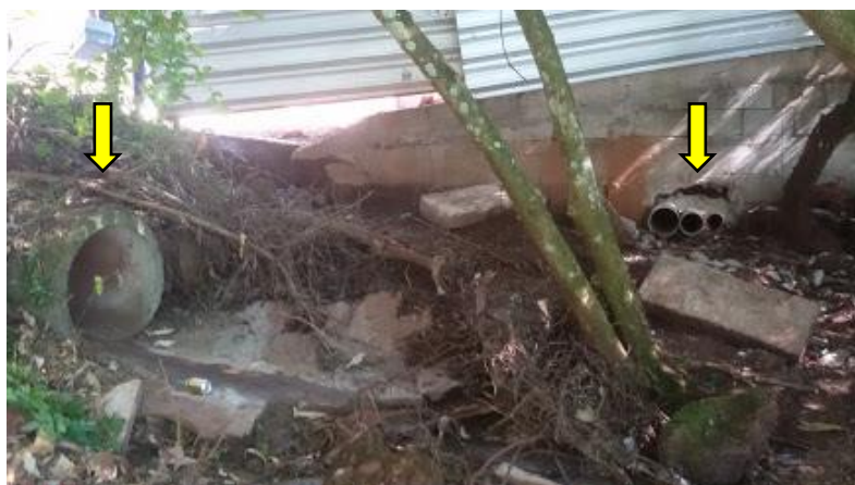
Figura 15 - Tubulações a montante da Lagoa do Gambá
