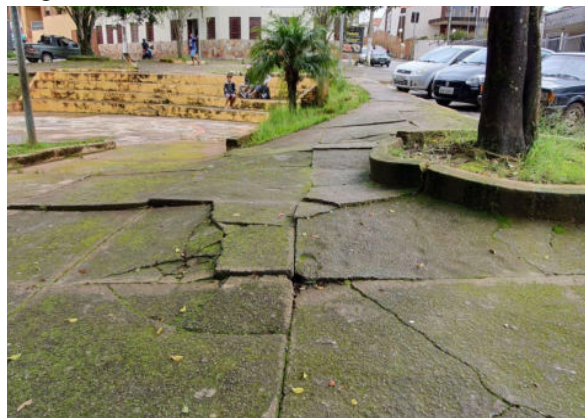
Figura 19 - Pavimento danificado antes da reforma
