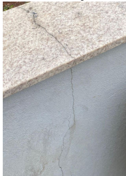
Figura 64 - Fissura geométrica do revestimento cimentício e do granito
