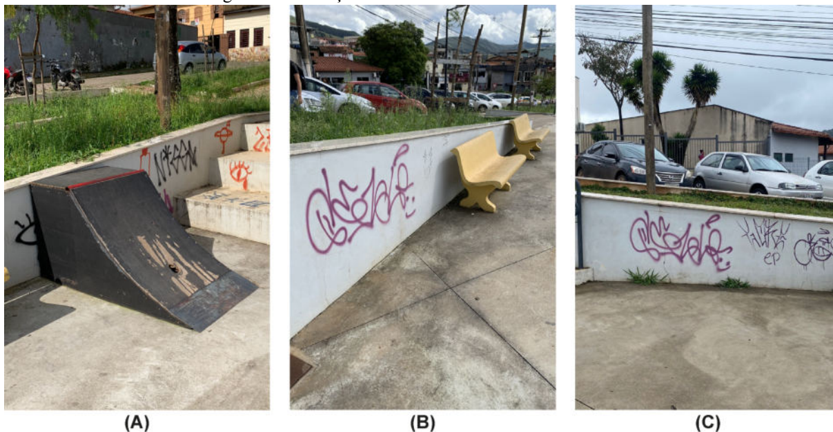
Figura 68 - Pichações nos canteiros dos muros de arrimo.
