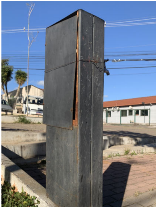
Figura 32 - Ferrugem e tampa solta no bebedouro
