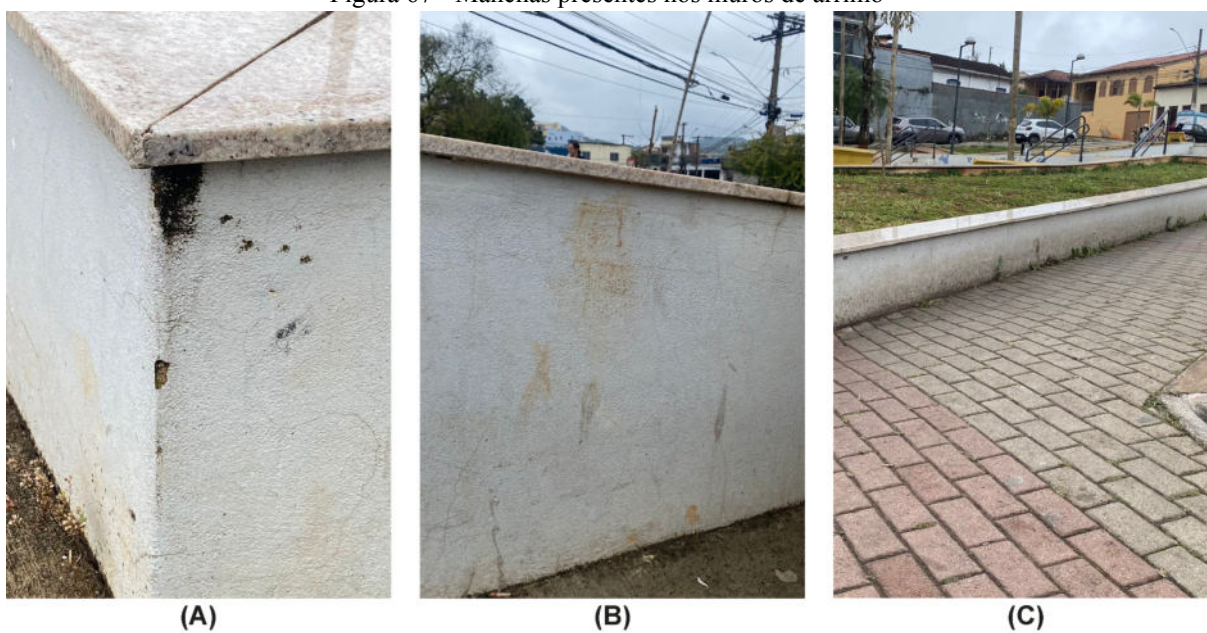
Figura 67 - Manchas presentes nos muros de arrimo
