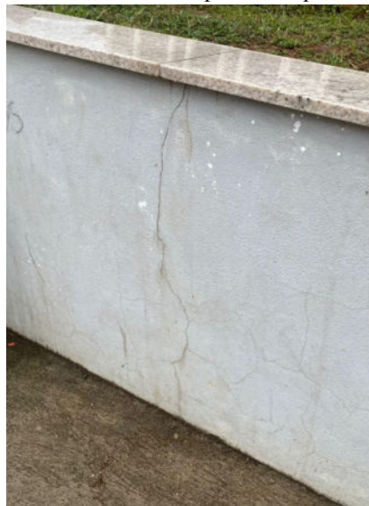
Figura 63 - Fissuras do revestimento cimentício: Geométrica ao centro e mapeadas na parte inferior
