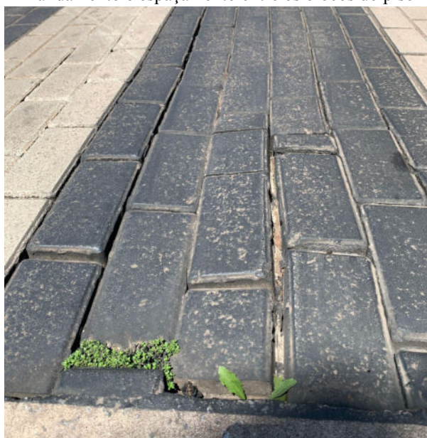
Figura 53 - Afundamento e espaçamento entre os blocos do piso intertravado
