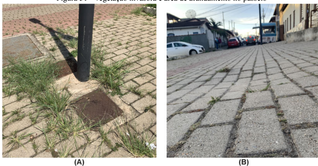
Figura 51 - Vegetação invasora e área de afundamento no passeio
