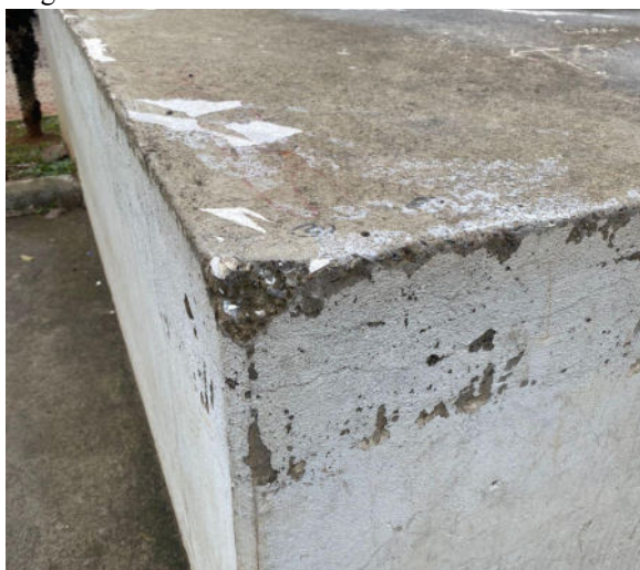
Figura 60 - Esborcinamento do concreto nos cantos
