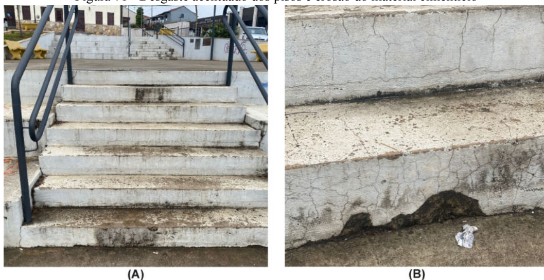
Figura 71 - Desgaste acentuado dos pisos e erosão do material cimentício
