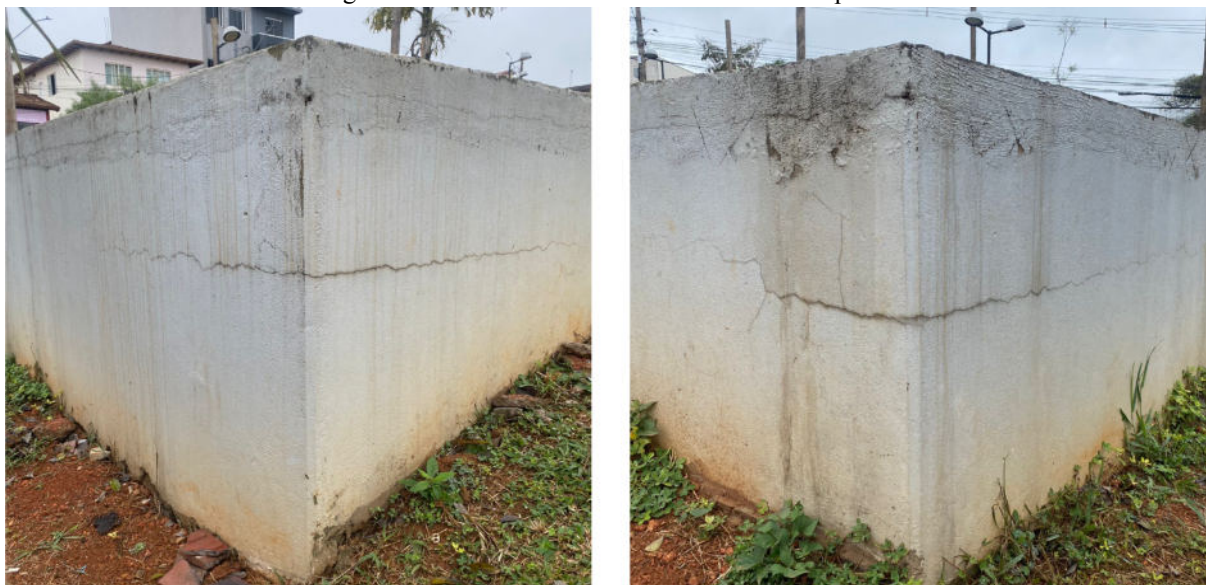
Figura 58 - Fissuras horizontais na alvenaria do palco
