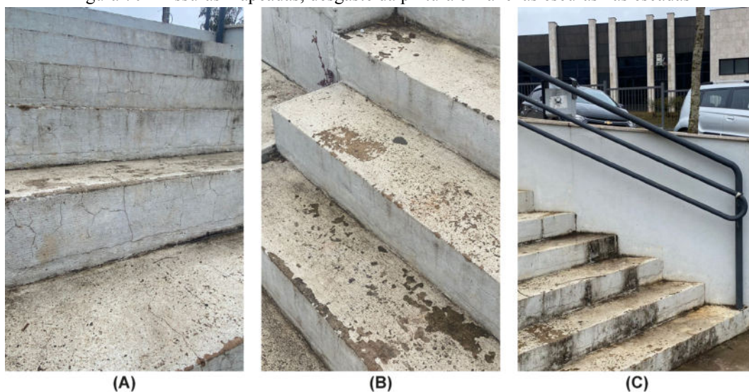
Figura 70 - Fissuras mapeadas, desgaste da pintura e manchas escuras nas escadas
