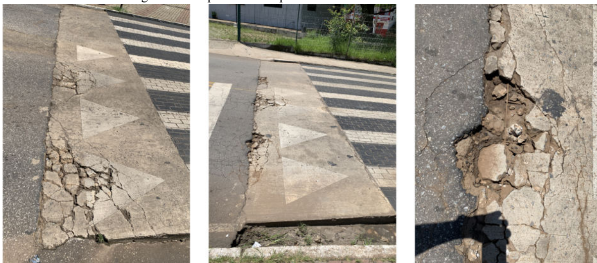
Figura 52 - Ruptura das rampas de concreto da travessia elevada
