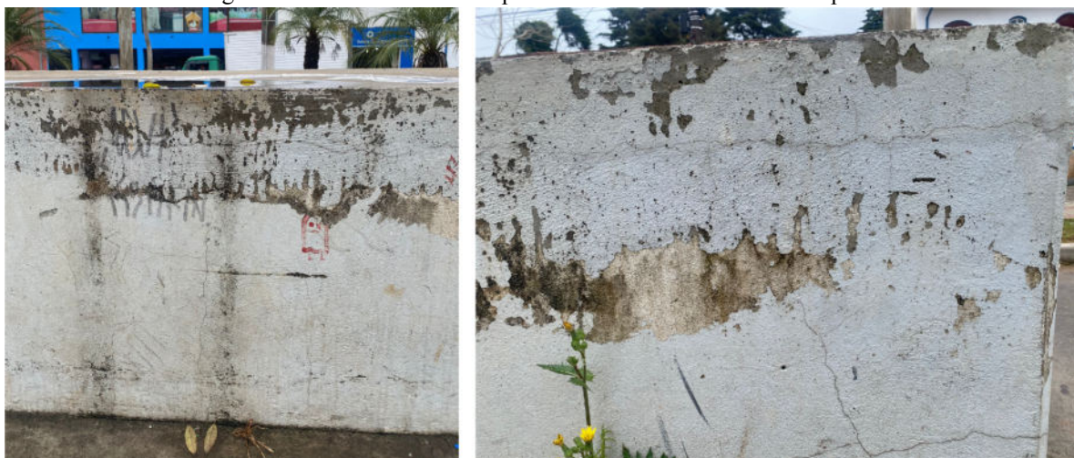
Figura 59 - Descascamento da pintura acrílica na face frontal do palco
