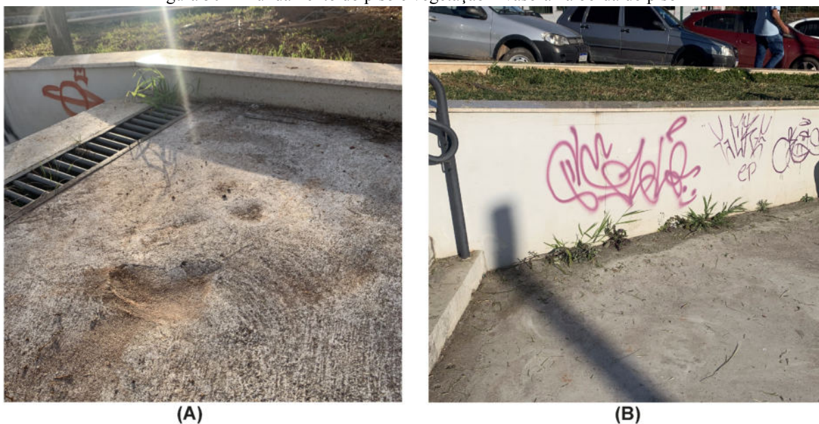
Figura 50 - Afundamento do piso e vegetação invasora na borda do piso
