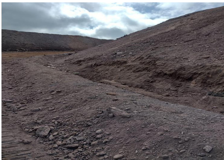
Figura 3 - Canal de drenagem aterro municipal de Ouro Preto – MG
