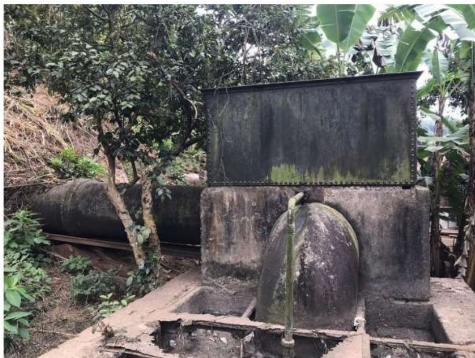
Figura 16: Tanque de desinfecção da Barra
