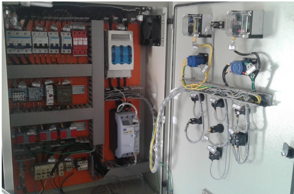
Figura 28: Painel de acionamento, proteção e controle de partidas Fonte: Pesquisa direta (2021)
