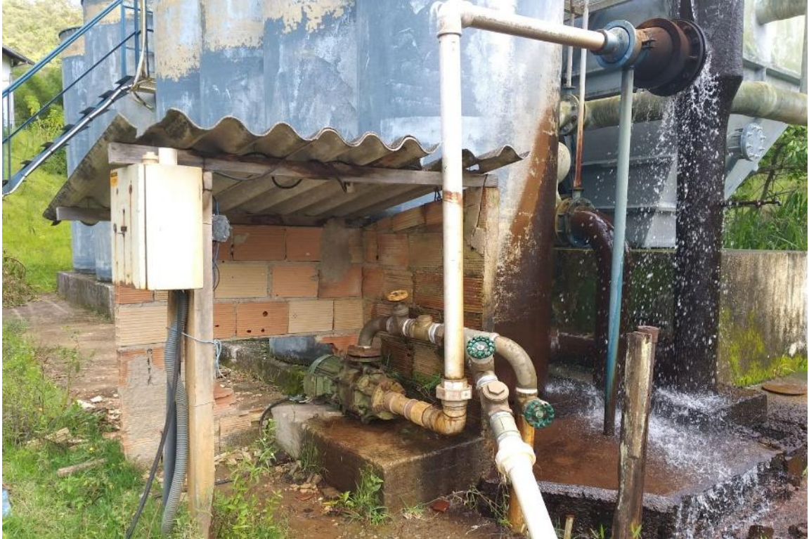
Figura 25: Estação Elevatória Fonte: Pesquisa direta (2021)
