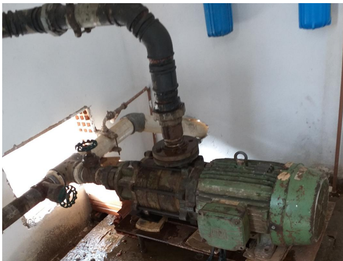
Figura 21 Características dos componentes de uma estação elevatória Fonte: Pesquisa Direta (2021)
