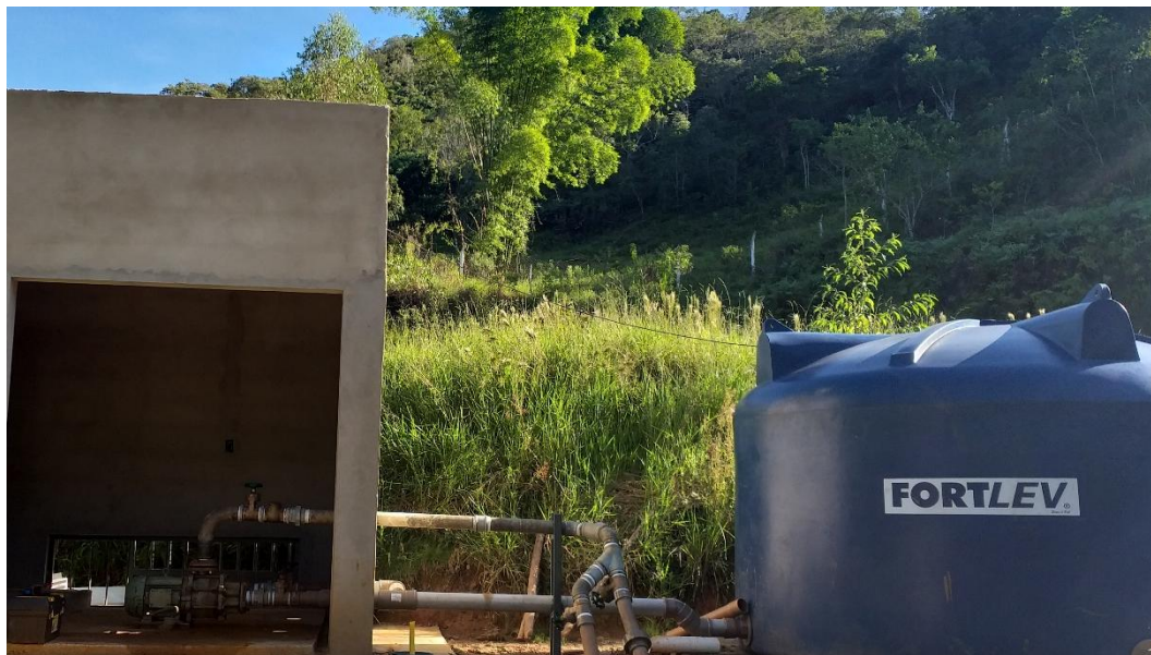
Figura 20: Instalação de Bombeamento Fonte: Pesquisa Direta (2021)
